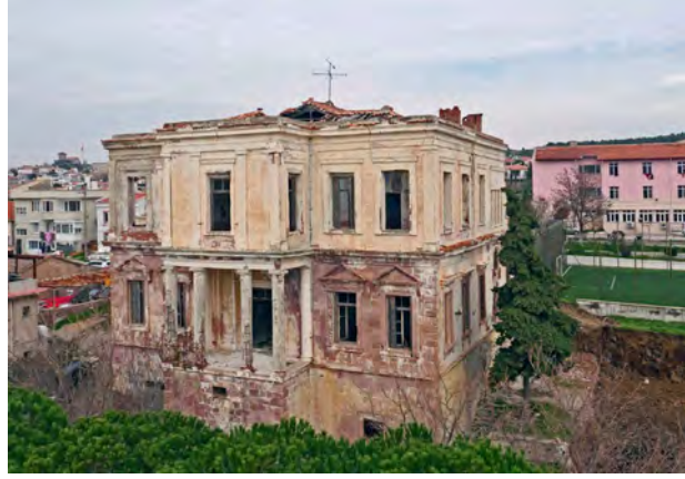
2. Kullanılmamaktan ve bakımsızlıktan kaynaklı olarak çatının yıkılması, dış etkilere açık kalan ana beden duvarları ile tüm malzemenin hızla tahrip olmasına neden olur.
